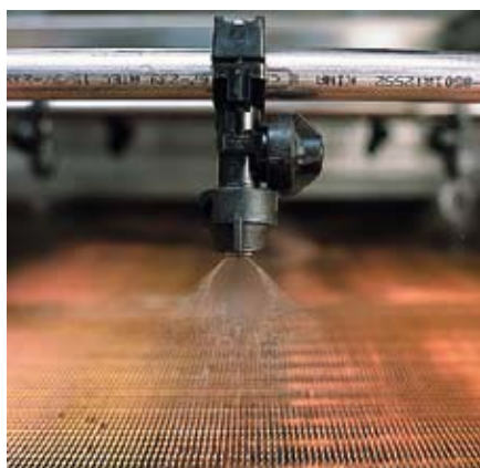
Herzstück des hybriden Rückkühlsystems ist die Sprühvorrichtung, welche das Medium versprüht.
